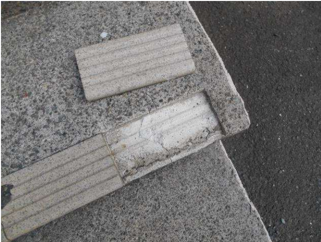
タイルが剥がれた様子
